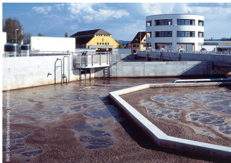
Biologische Reinigungsstufe in der Kläranlage Dresden-Kaditz
